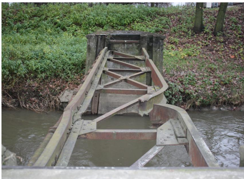
Rys. 7. Uszkodzony pomost roboczy jazu fortecznego nr 11 (St.W. XI) na rzece Ślęży
