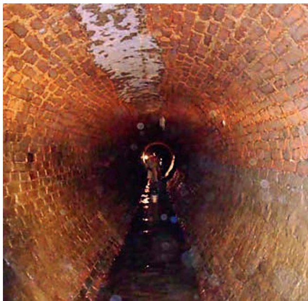
Ryc. 8. 130-letni kanał ceglany w Kalkucie wymagający pilnej rehabilitacji [1]
