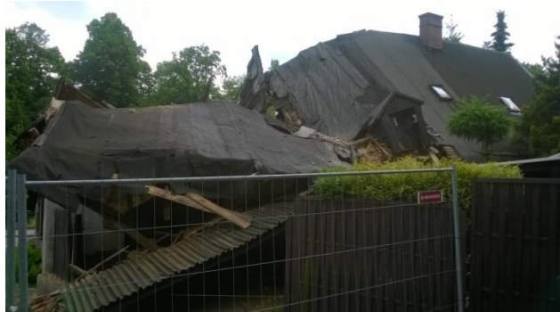
Rys. 3. Zawalenie się dachu budynku jednorodzinnego pod wpływem zniszczenia więźby drewnianej przez owady Fig. 3. Collapsing roof of a detached house as a result of damage by insects
