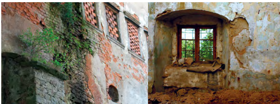
Rys. 2. Zawilgoceń murów wywołane niesprawnym odwodnieniem oraz brakiem izolacji w poziomie posadowienia
