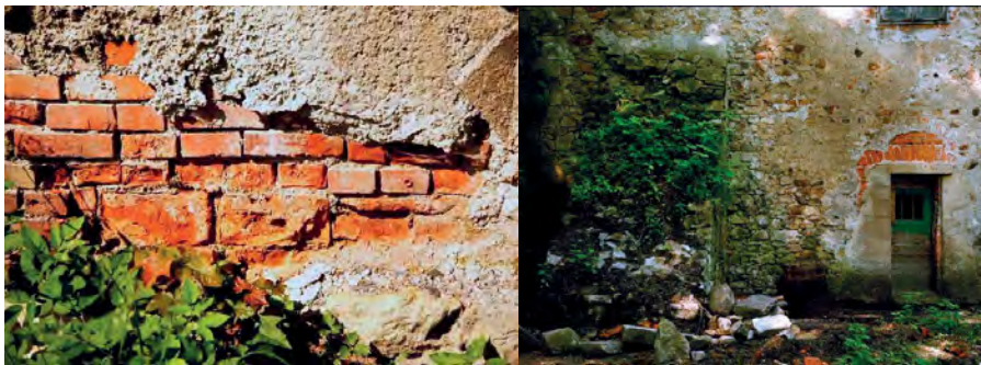
Rys. 3. Uszkodzenia wywołane czynnikami środowiska
