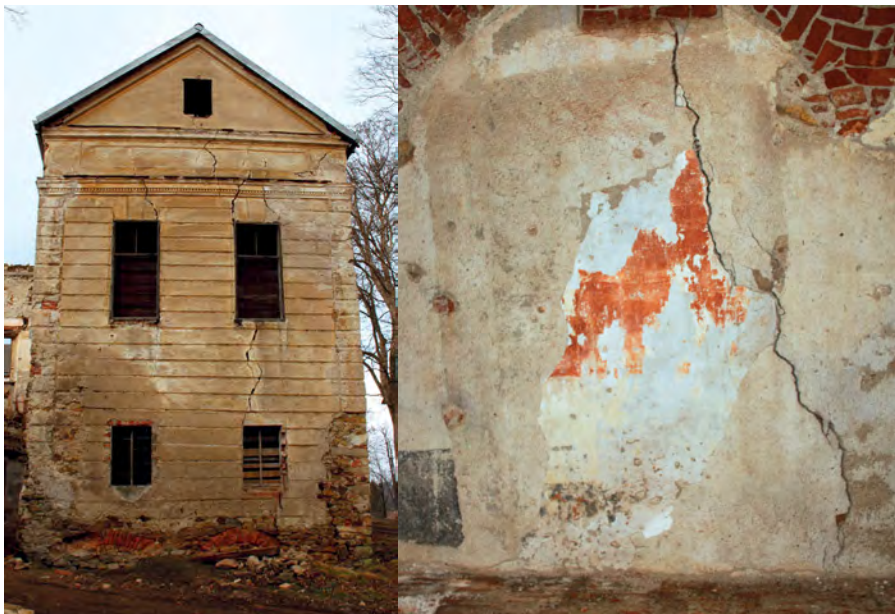
Rys. 1. Pęknięcia i zarysowania ścian zewnętrznych i wewnętrznych konstrukcji
