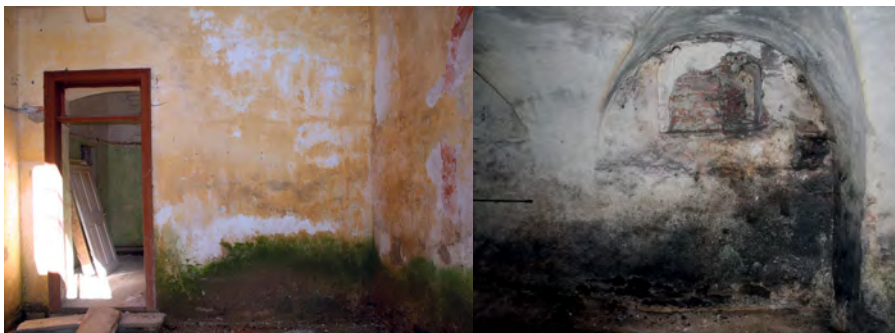
Rys. 4. Rozwój korozji biologicznej (grzybów pleśniowych) w pomieszczeniach zlokalizowanych na parterze
