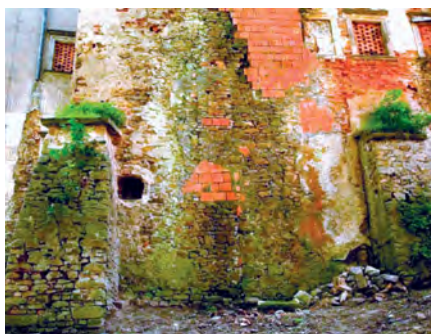
Rys. 6. Elewacja zewnętrzna północna z widocznymi licznymi przemurowaniami
