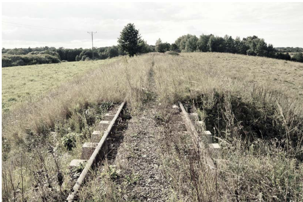
Ryc. 5. Zarastające torowisko w okolicy Górowa Iławeckiego. Źródło: fot. E. Krawiecka Fig. 5. The railway track overgrown with plants near Górowo Iławeckie. Source: photo E. Krawiecka
