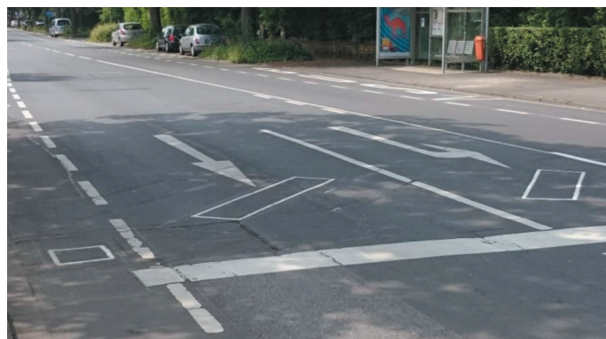
Fot. 1. Pętla indukcyjna zlokalizowana w jezdni Źródło: archiwum autorów
