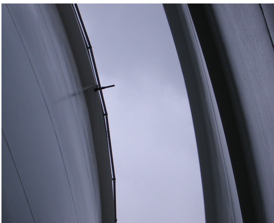
Zdjęcie uchwyty zamontowanego na koronie zbiornika fot. arch. własne
