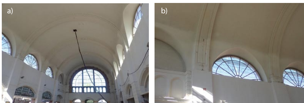
Rys. 4. Żelbetowe sklepienia kolebkowe (łupiny) nad Halą Główną Dworca Kolejowego Gdańsk Główny – widok: a) ogólny, b) w miejscu oparcia stalowych wiązarów konstrukcji dachu
