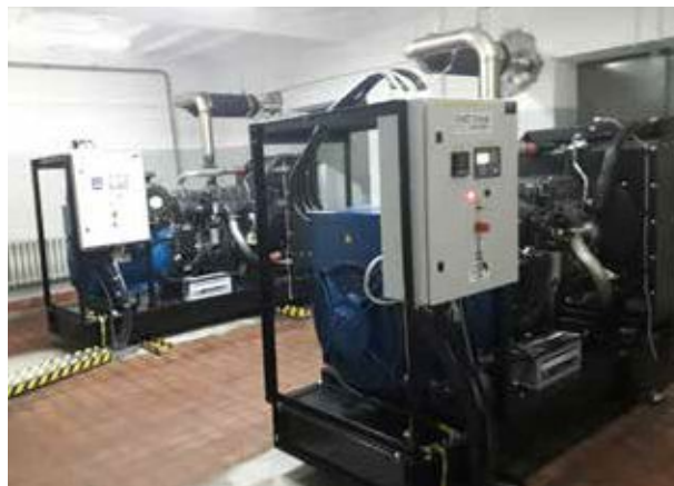
Fot. 1. Widok nowych awaryjnych agregatów Diesla
