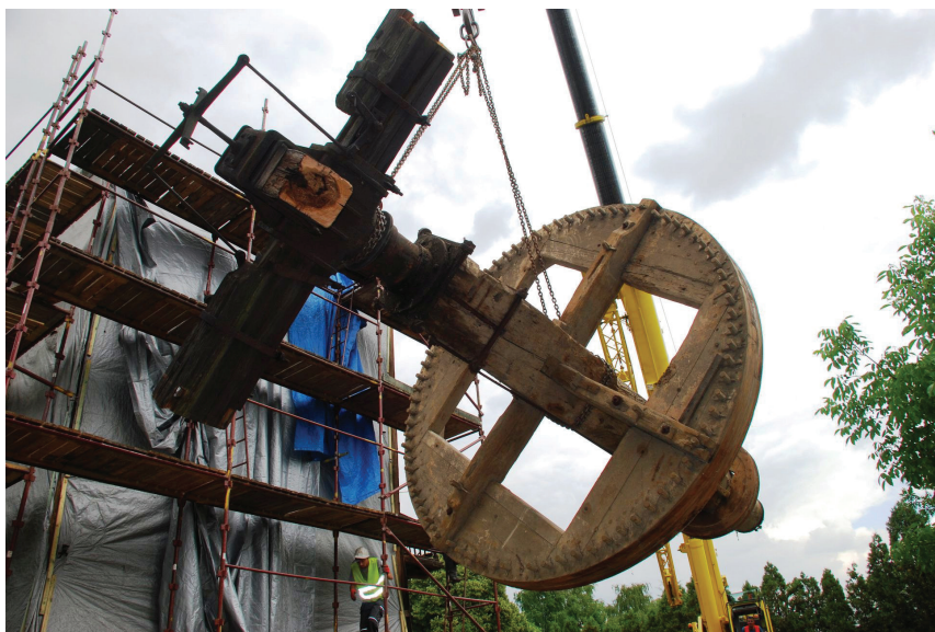
Fot. 1. Wiatrak-koźlak w Lesznie w trakcie relokacji – demontaż wału głównego z kołem palcycznym; fot. J. Jankowski, czerwiec 2018 r.
