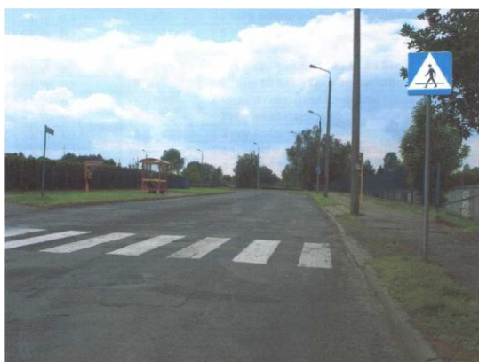
Rys. 3. Droga osiedlowa o niezbyt dobrej nawierzchni
