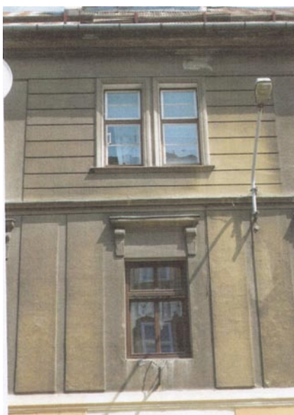
Rys. 2. Fragment elewacji frontowej ze śladami degradacji pod gzymsem oraz oknem piętrowym; widoczne delikatne zdobienia fasady
