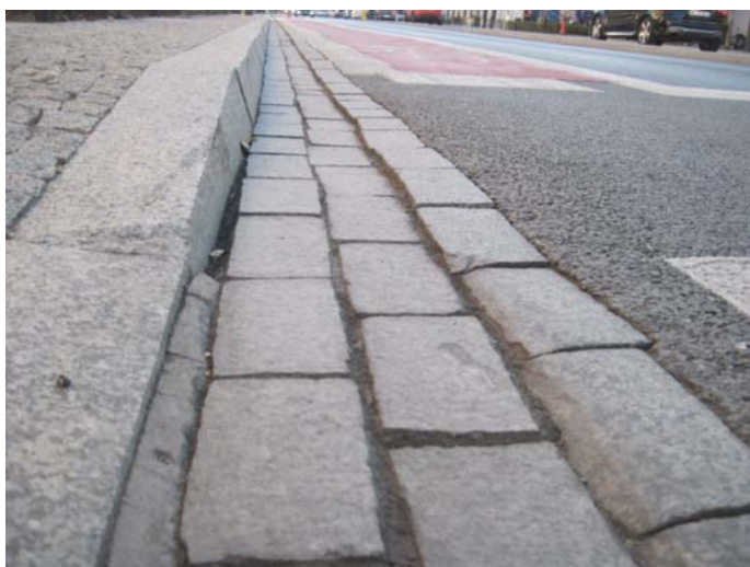
Fot. 2. Przejście dla pieszych z krawężnikiem i krawężnią ścieku ściętymi piłą mechaniczną
