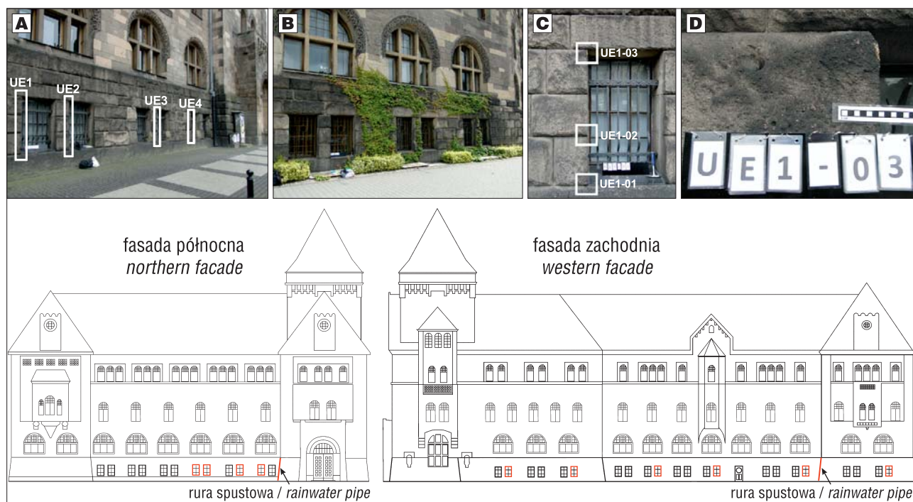
Ryc. 2. Miejsca poboru próbek do analiz z przykładową dokumentacją fotograficzną (na planie elewacji na czerwono zaznaczono miejsca poboru próbek do analiz w ościeżach okiennych oraz w sąsiedztwie rur spustowych); A – fasada północna, B – fasada zachodnia, C i D – przykładowe miejsca poboru próbek
