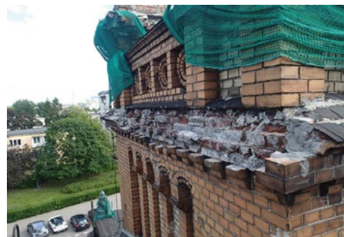
Fot. 4. Wieżyczka W1 – przy- kładowe uszkodzenia gzymsu
