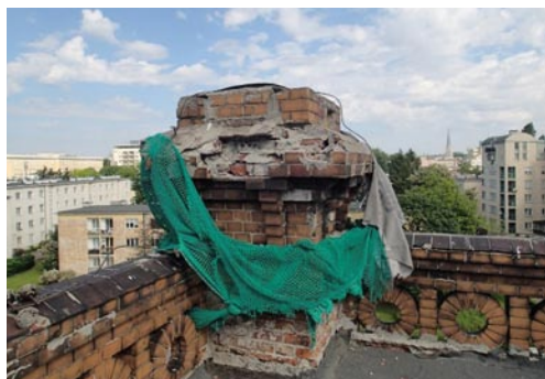
Fot. 3. Wieżyczka W1 – przy- kładowe uszkodzenia wieżyczki
