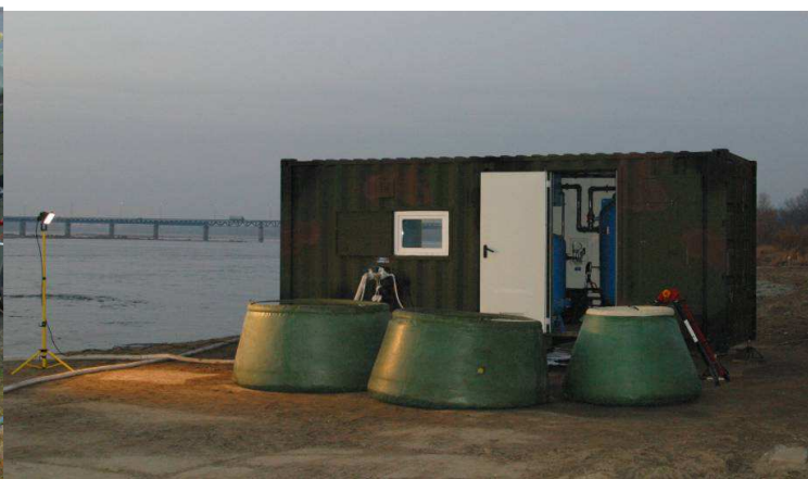
Fot. 6 Stacja KSW-12
