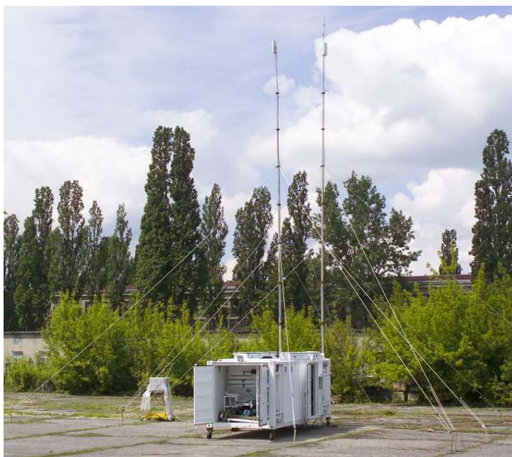
Rys. 2. Mobilny kontener centralnej stacji sterowania
