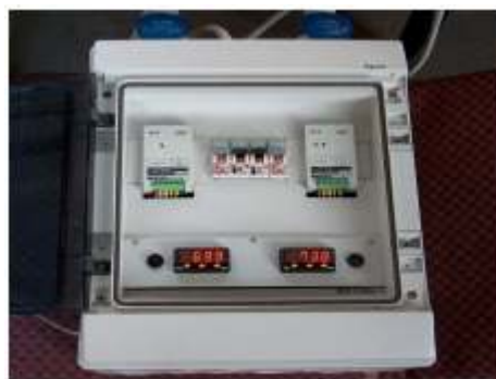
Rys. 7. Fotografia zespołu pomiarowo-regulacyjnego i zasilającego do badań termograficznych
