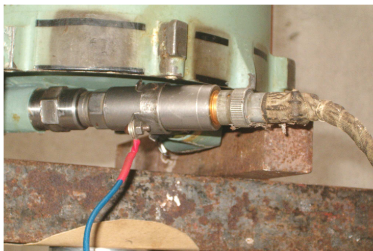
Fot. 4. Czujnik pomiaru ciśnienia wraz z reduktorem i kablem sygnałowym.
