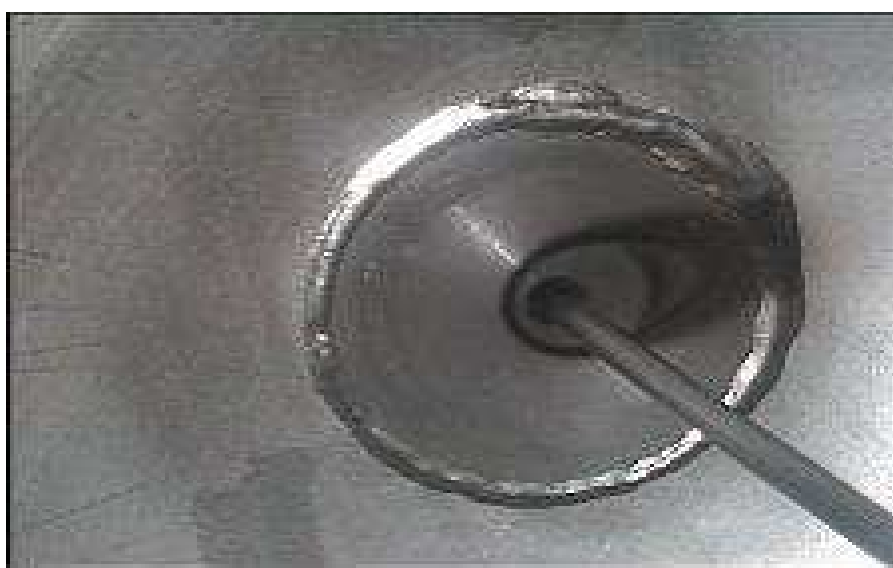
Rys.7. Wnętrze zbiornika, widoczne połączenie spawane króćca napelniania, nierównomierna grań spoiny, przetop pełny.
