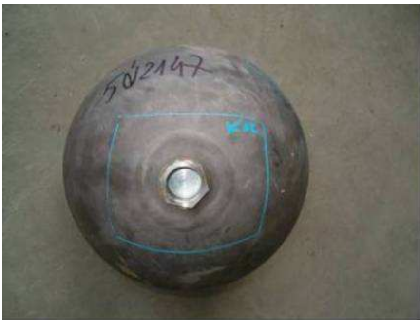
Rys.16. Wycinek K12 z korkiem i jego połączeniem spawanym z płaszczem zbiornika.
