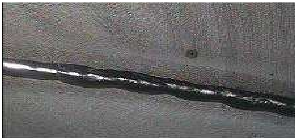
Rys.6. Wnętrze zbiornika, widoczny spaw obwodowy i wtrącenie (pobrano wycinek K17).
