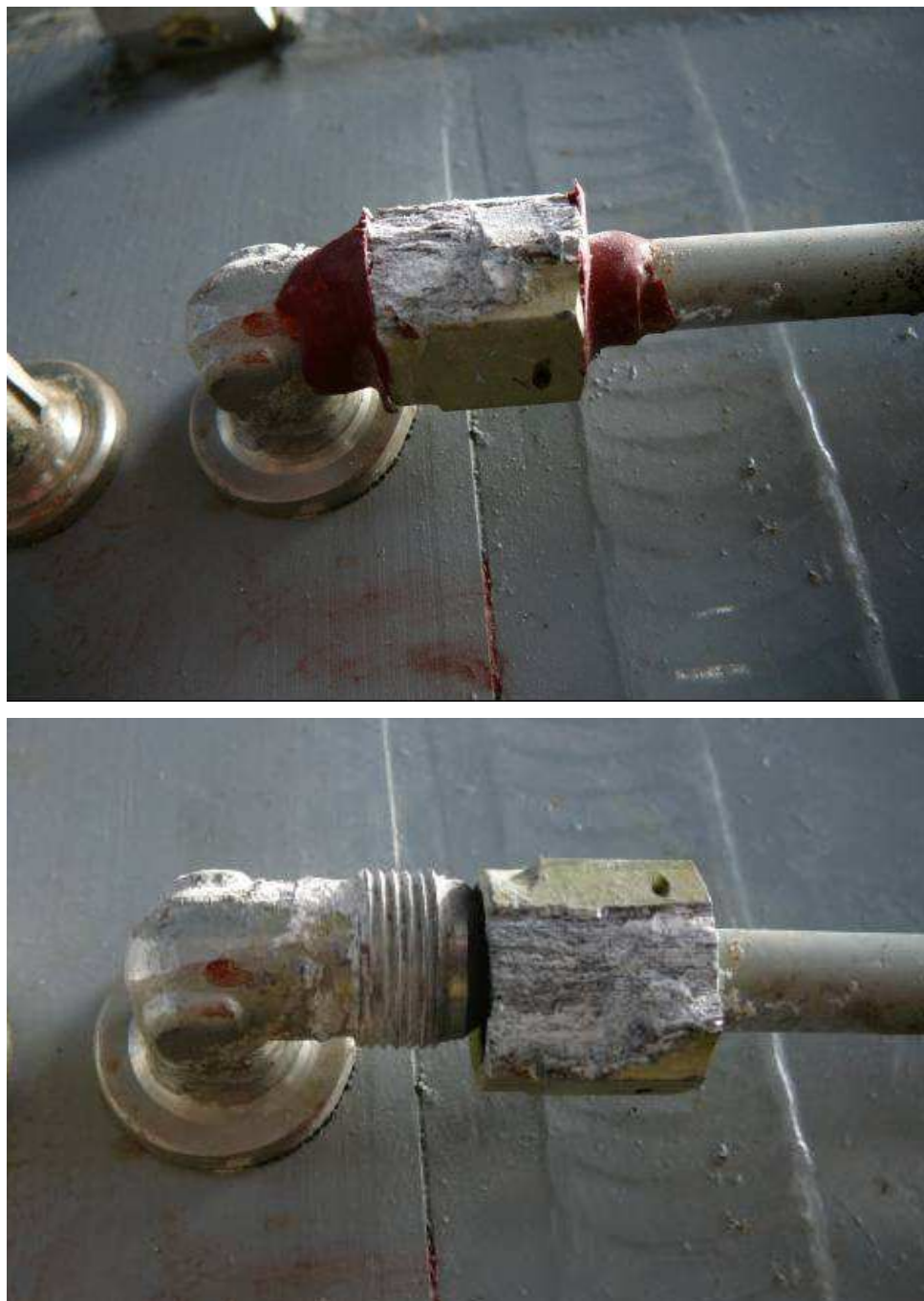
Fot.3. Zmiany korozyjne elementów złącza (zarówno nakrętki jak i króćca)
