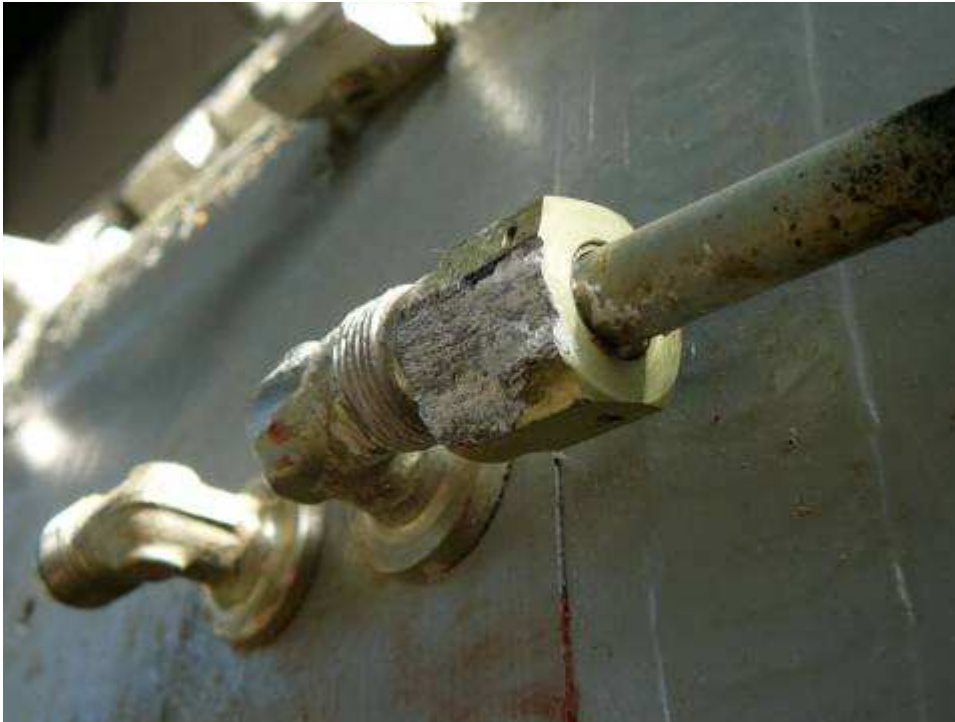
Fot.4. Wielkość ubytku materiału
