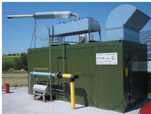
Rys. 2. Kompaktowy kontener z izolacją dźwiękową – silnik gazowy, turbina, wymienniki ciepła
