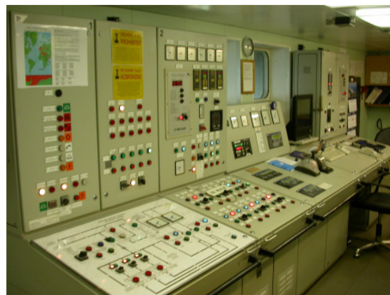
Rys. 6. Widok centrali manewrowo-kontrolnej przykładowego statku
