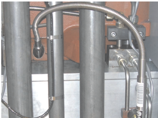
Fig. 4. Installation place HTT-sensor Rys. 4. Zamontowany czujnik HTT
