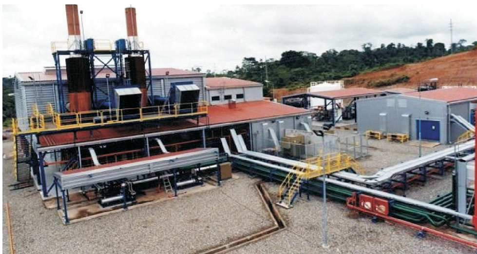
Fig. 4. Dygoil power plant powered by two Wärtsilä 16V32GD gas-diesel engines Rys. 4. Elektrownia Dygoil zasilana przez dwa gazowe silniki o ZS Wärtsilä 16V32GD
