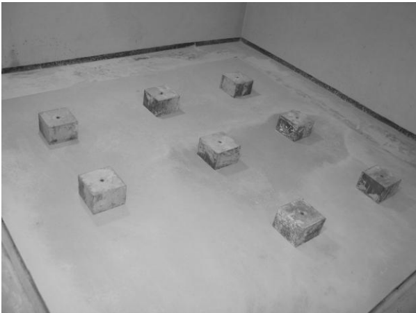
Rys. 1. Komora nadawcza z zamontowaną podłogą pływającą. Fig. 1. Broadcasting room with floor coverings.
