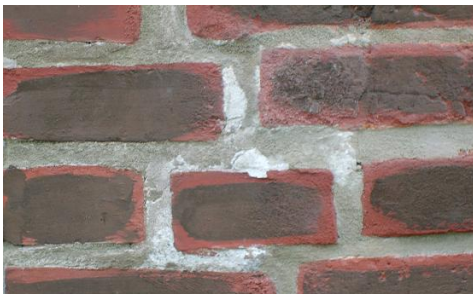
Fot. 4. Fragment muru z wykwitem soli na zaprawie.
