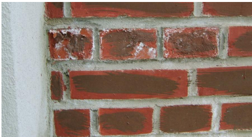
Fot. 3. Fragment muru z wykwitem soli występującym na licu cegły.
