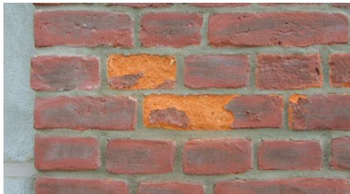
Fot. 2. Fragment muru ze zniszczoną warstwą wierzchnią cegieł.
