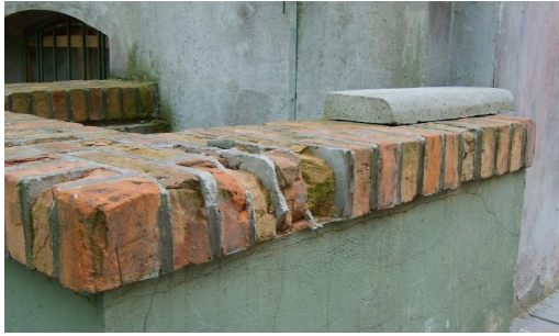
Fot. 1. Przykład zastosowania w murze zbyt mocnej i szczelnej zaprawy.
