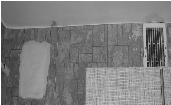
Fot. 1. Skraplanie się pary wodnej przy wlocie kratki wentylacyjnej, opis w tekście.
