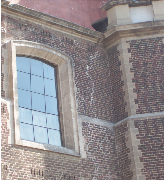
Rys. 5. Ślady napraw uszkodzeń murów elewacji „starej” Katedry [25] Fig. 5. Trace of repair of facade masonry of „old” Cathedral [25]
