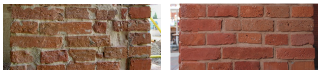
Rys. 2. Ściany ceglane przed (lewa) i po (prawa) modernizacji. Fig. 2. Brick walls before (left) and after (right) modernization.
