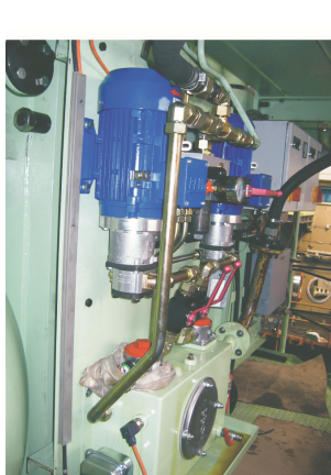
Rys. 13. Stacja pomp Fig. 13. Station pump
