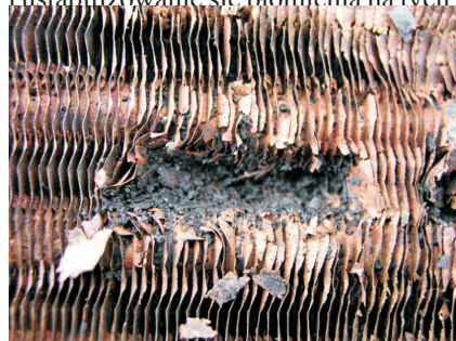
Rys. 5. Fragment wkładu chłodnicy mieszanki z zalegającymi w nim zanieczyszczeniami
