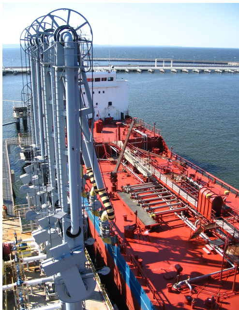
Rys. 6. Portowe ramiona przeładunkowe podłączone do instalacji statkowej
