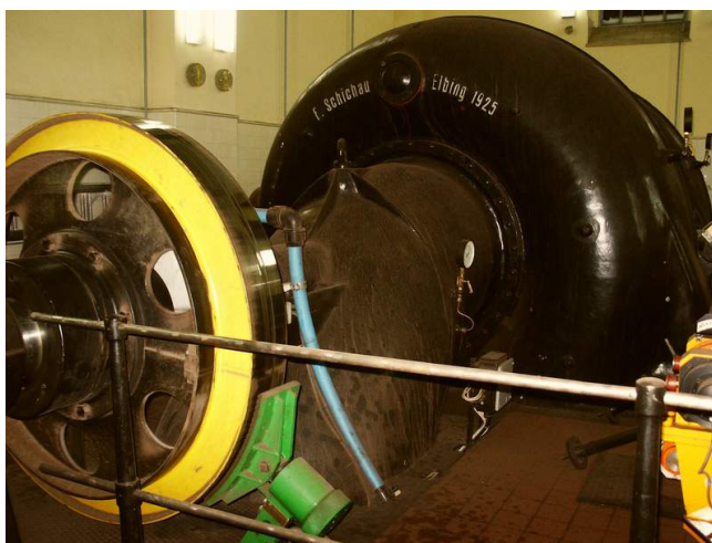
Fot. 1. Turbina elektrowni wodnej
