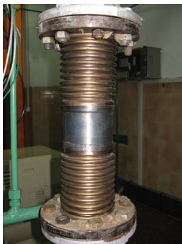
Rys. 3. Złącze kompensacyjne kanału spalin wylotowych silnika LEYLAND typu SW400 Źródło: zdjęcie wykonane przez autora.
