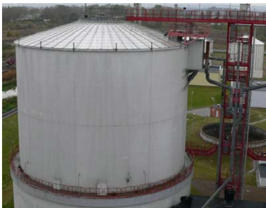
Fot. 1. Zbiornik ZKF w oczyszczalni ścieków Źródło: zdjęcie wykonane przez autora.
