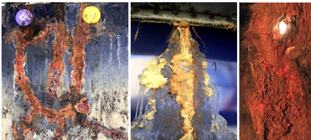
Fot. 3. Wżery korozyjne i pęknięcia w poszyciu ZKF
