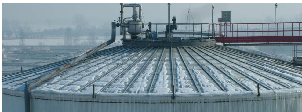
Fot. 6. Widok dachu pracującego zbiornika po opadach śniegu, temperatura -5\text{ }^{\circ}\text{C}
