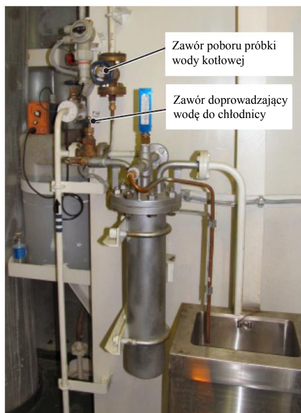
Rys. 2. Miejsce i sposób poboru wody kotłowej do analizy w siłowni statku dla kotła niskociśnieniowego [6]
