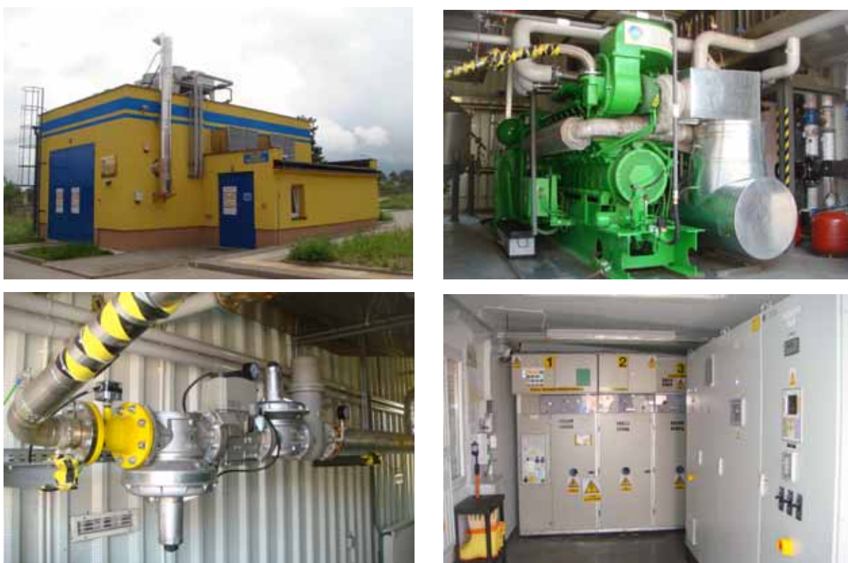
Rys. 1. Biogazowy zespół kogeneracyjny z silnikiem GE JENBACHER JMS 316 GS-B.LC eksploatowany w Oczyszczalni Ścieków WARTA S.A. w Częstochowie
