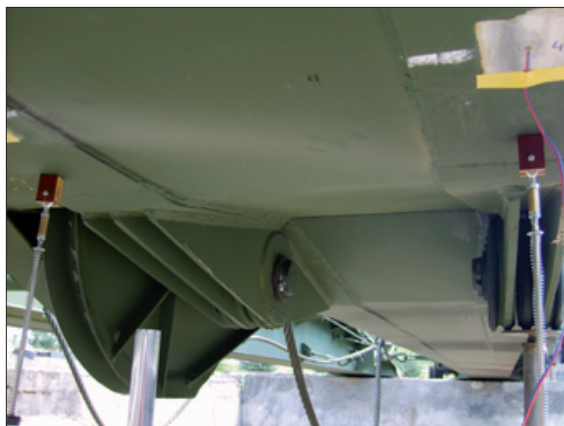
Rys. 7. Widok obrazujący położenie czujników potencjometrycznych do pomiaru przemieszczeń na dźwigarze prawym mostu
