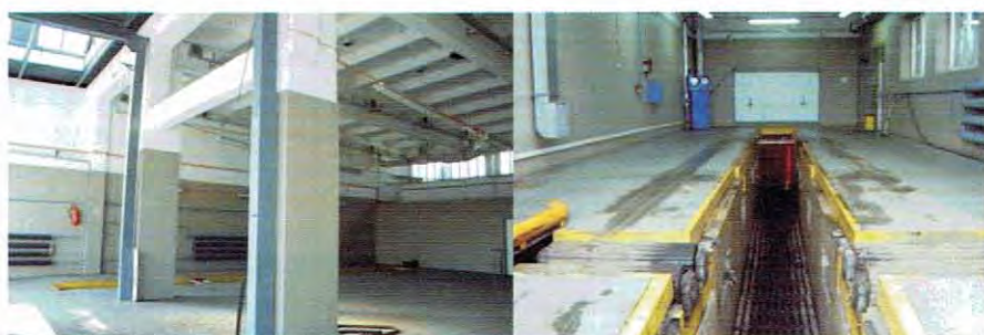
Rys. 5. Stanowiska do napraw i obsługi autobusów CNG na zajezdni MPK Rzeszów przy ul. Trembeckiego
