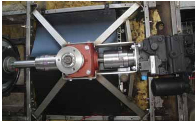
Rys. 5. Widok zespołu napędu wentylatora i pompy hydraulicznej silnika śmigła głównego. Pod ramą wsporczą przekładni kątowej znajduje się zbiornik płynu hydraulicznego
