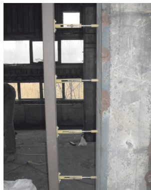
Rys. 12. Usytuowanie mierników MCP rejestrujących przemieszczenia trwałe
