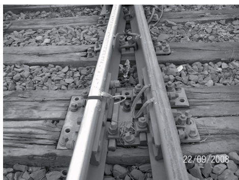
Rys. 5. Zagłębiona podkładka podłączona od strony bardziej obciążonego toru; widoczny brak wkrętów
