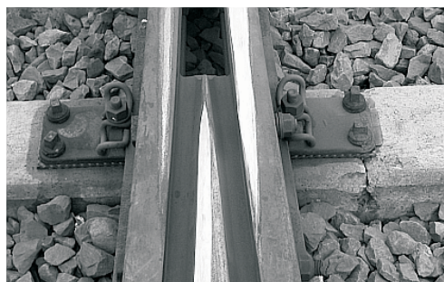
Rys. 11. Pęknięcie podrojazdnicy pod dziobem krzyżownicy kuto-spawanej przechodzące przez osie dybli
