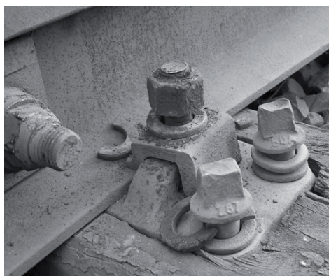
Rys. 6. Popękane pierścienie sprężyste i zagłębiona podkładka
