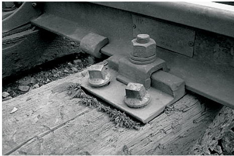
Rys. 3. Wyraźne ślady poprzecznego ruchu szyny w torze zwrotnym; przecięte włókna drewna i odchylone wkręty
