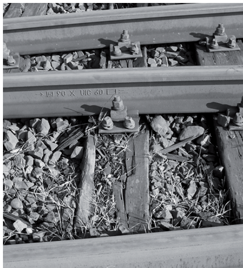
Rys. 14. Zmuszała podrozdnic sosnowa po 18 latach eksploatacji
