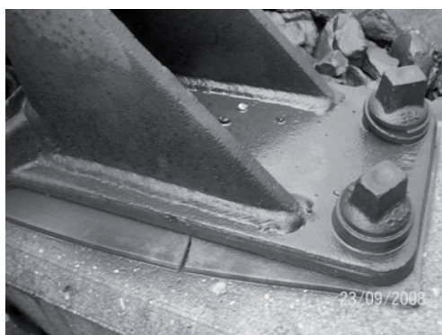
Rys. 13. Pęknięta i wysuwająca się przekładka spod koziołka kierownicy rozjazdu
