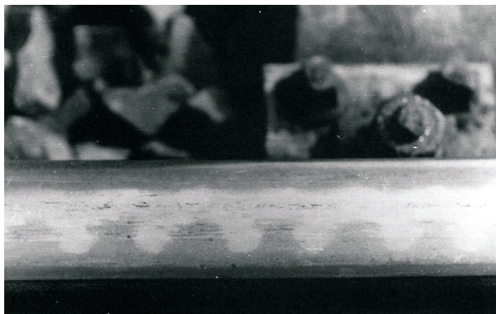
Rys. 5. Zużycie faliste szyn o falach krótkich; jasne pasma to wyniosłości, ciemne — zagłębienia
