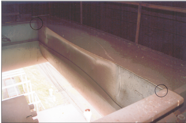
Rys. 7. Deformacja belki poprzecznej i pęknięcia zmęczeniowe w narożach konstrukcji
