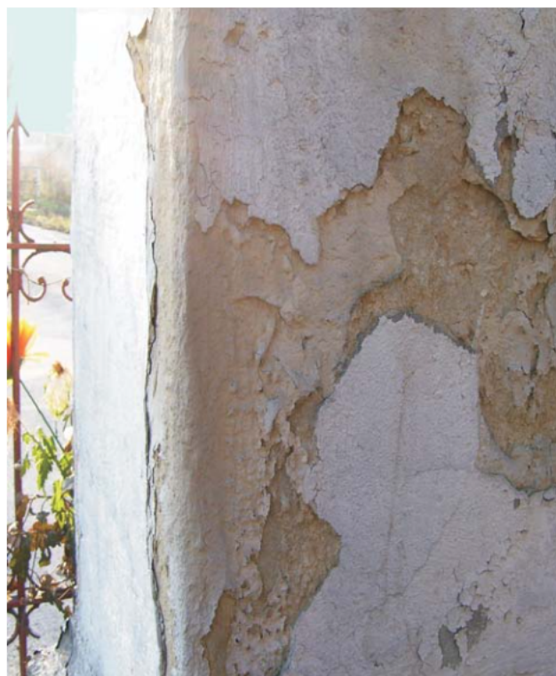
Ryc. 8. Fragment Figury Chrystusa Ukrzyżowanego, z 1876 r. (skrzyżowanie ulic Myślenickiej i Cechowej), fundacji gminy Kurdwanów. Zjawisko odspajania się zewnętrznej warstwy piaskowca pokrytego farbą. Wszystkie fot. M. Sowa
