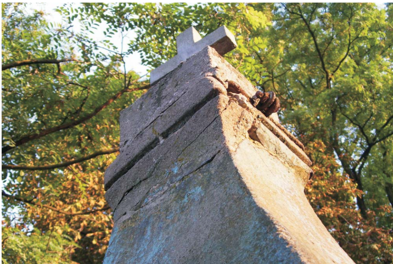
Ryc. 10. Fragment Figury Chrystusa Ukrzyżowanego, z 1861 r. (cmentarz komunalny przy ulicy Biezanowskiej), fundacji gminy Prokocim. Widoczne głębokie spęknięcia kamiennego elementu. Obie fot. M. Sowa
