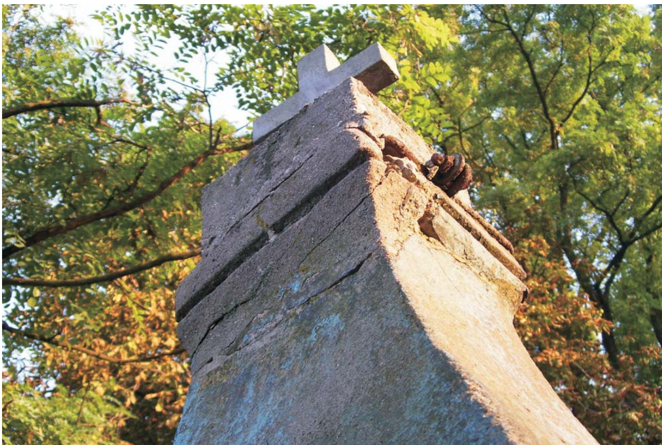
Ryc. 10. Fragment Figury Chrystusa Ukrzyżowanego, z 1861 r. (cmentarz komunalny przy ulicy Bieżanowskiej), fundacji gminy Prokocim. Widoczne głębokie spękania kamiennego elementu. Obie fot. M. Sowa
