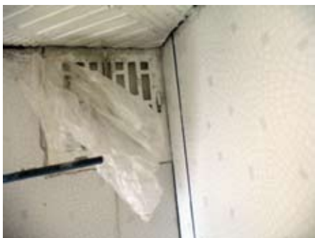
Rys. 4. Przysłonięta folią kratka wentylacyjna w łazience z widocznymi fragmentami grzyba.
