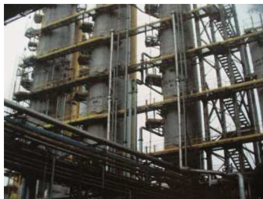
Rys. 3. Fragment instalacji do oczyszczania gazu koksowniczego w Koksowni Radlin.
