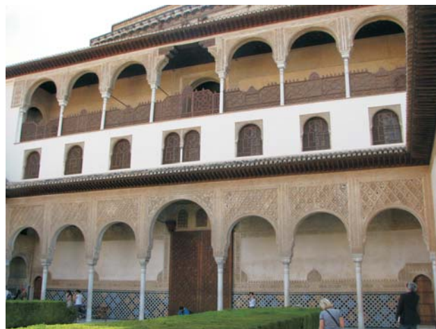
Ryc. 5. Grożące zawaleniem ściany w Pałacu Nasrydów spięte kotwami
