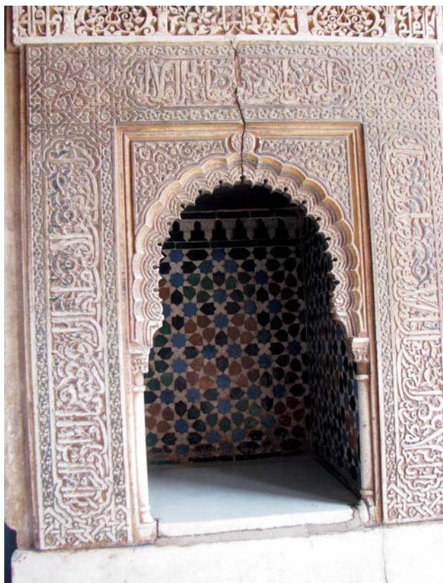
Ryc. 4. Pęknięcie detalu architektonicznego w Pałacu Nasrydów
