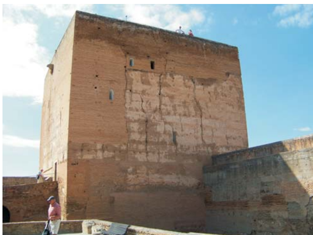
Ryc. 3. Pęknięte ściany wieży fortyfikacji Alcazaba
